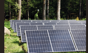
⑥ Panneaux photovoltaïques
