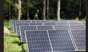
⑥ Panneaux photovoltaïques
