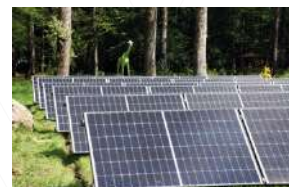
② Panneaux photovoltaïques
